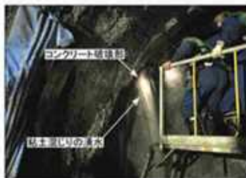
大量湧水発生状況（深度 350m）
