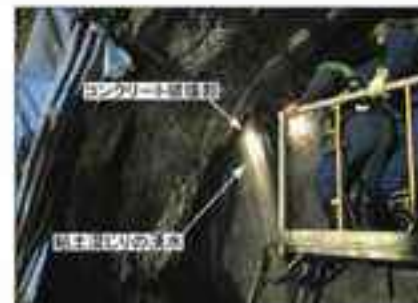
大量湧水発生状況（深度 350m）
