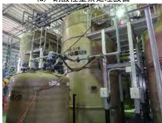
(c) 脱ホウ素設備(1号機)
