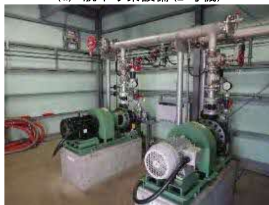
(f) 揚水設備
