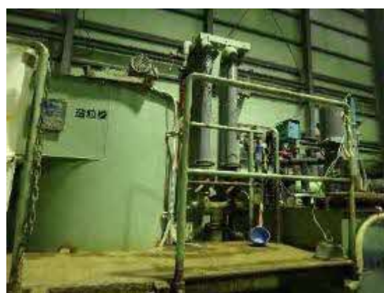
(b) 濁水処理設備
