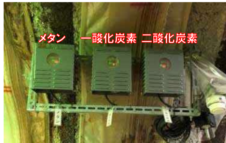
地下の環境を監視するセンサー
