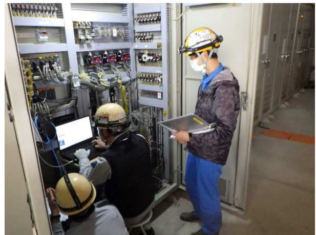
(b) 制御盤の整備
