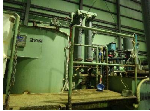
濁水処理設備
