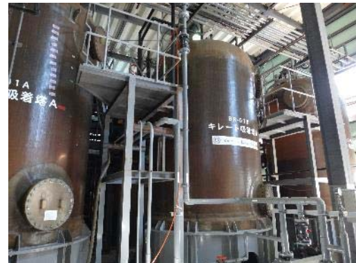
脱ホウ素設備(2号機)
