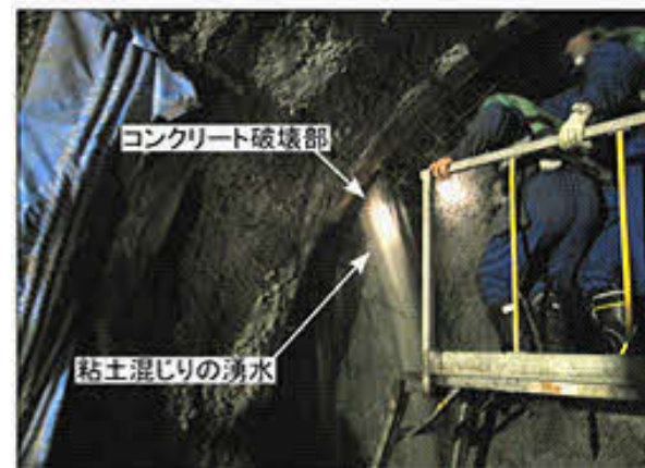
大量湧水発生状況(深度350m)
