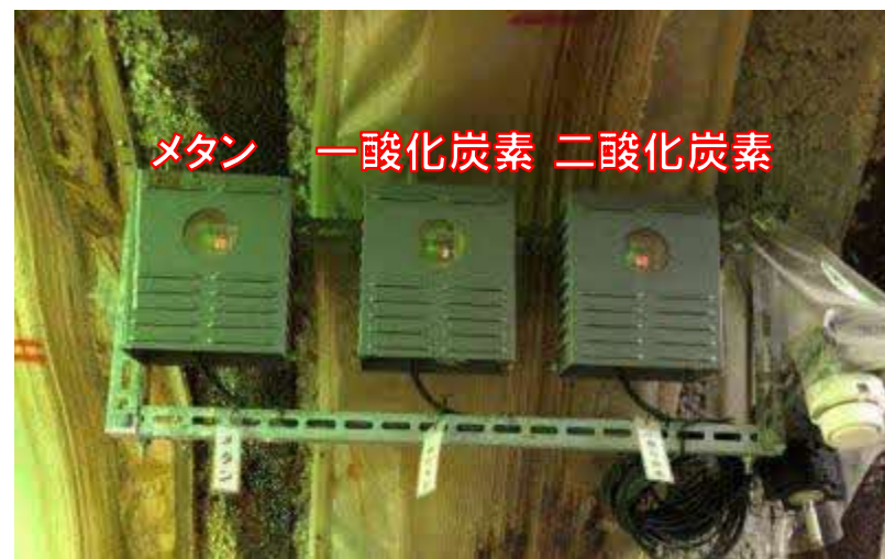
地下の環境を監視するセンサー
