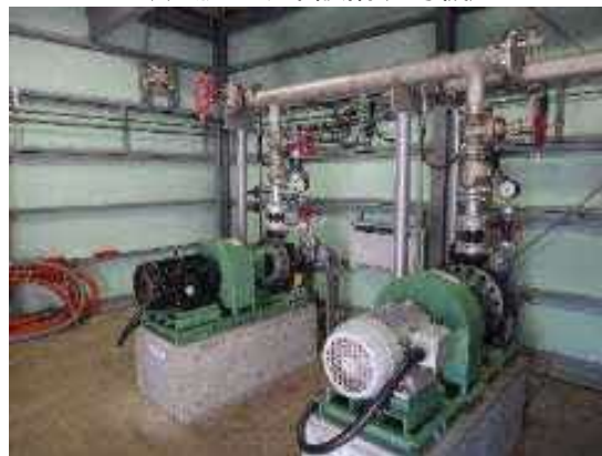
(f) 揚水設備
