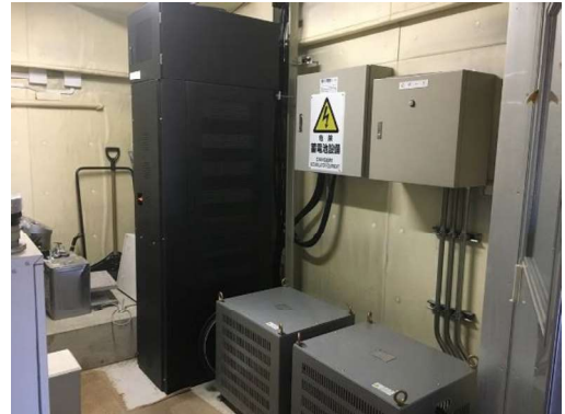
道と川の駅「花ロードえにわ」 蓄電池設備(恵庭市 HP)
