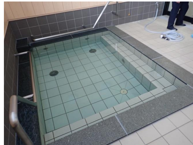
浴室(男性) 洗い場は3つ設置。
