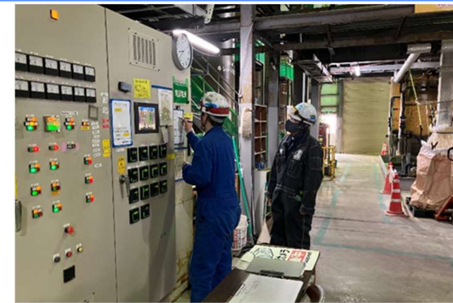
排水処理設備の運転・監視
