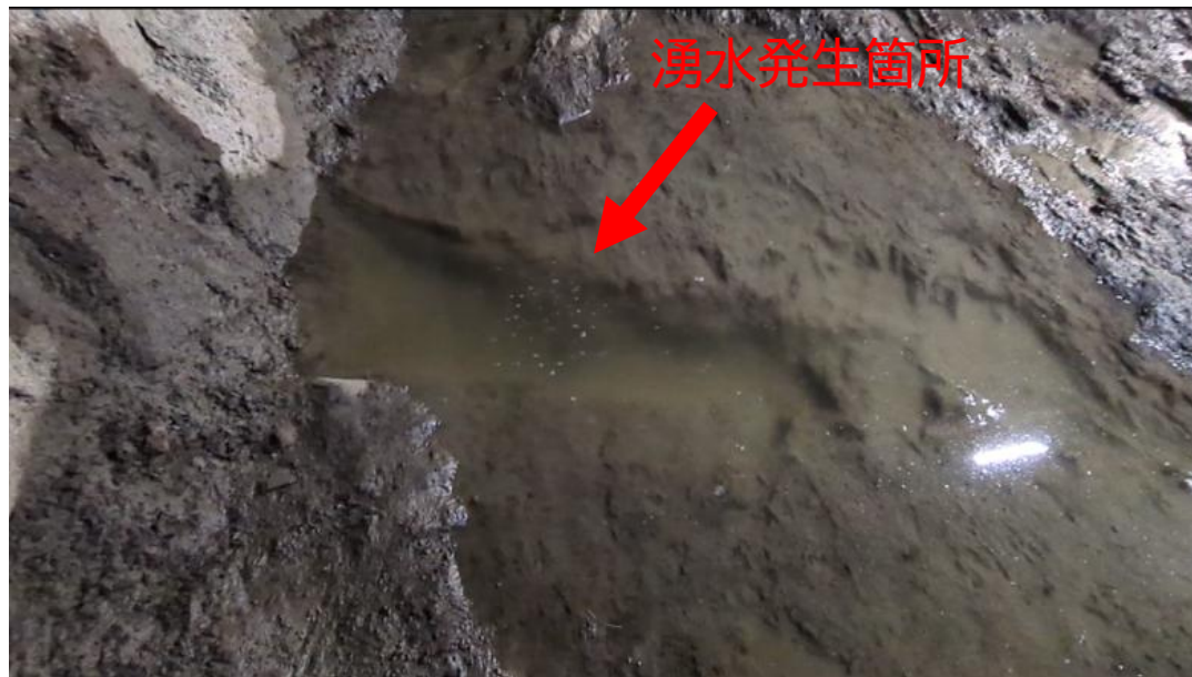
断層からの湧水の状況 (試験坑道8)
