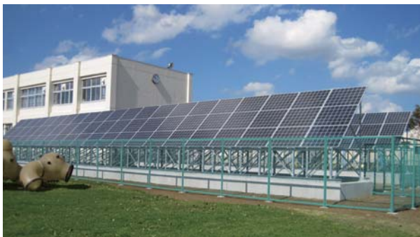
▶ 幌延小学校の太陽光発電
