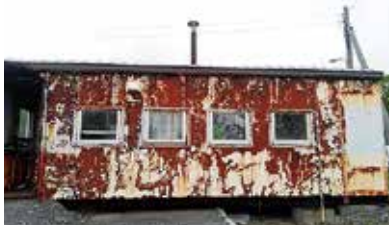
海側から見た待合室。潮風による腐食が激しく駅名も判別不能になっています。
