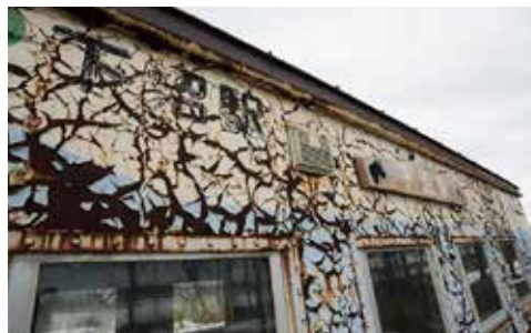
サビでボロボロになった下沼駅の外壁
