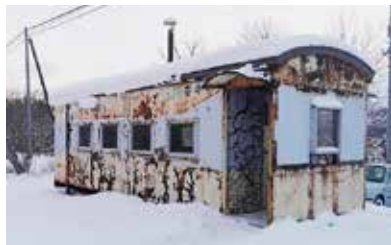
外見は劣化が激しいですが、窓が健在です。
