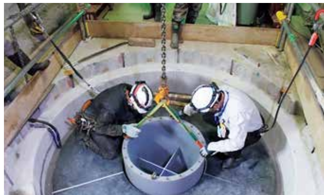
写真 模擬の人工バリアを設置している様子 令和3年度はこれらの解体方法を検討する試験を行います
