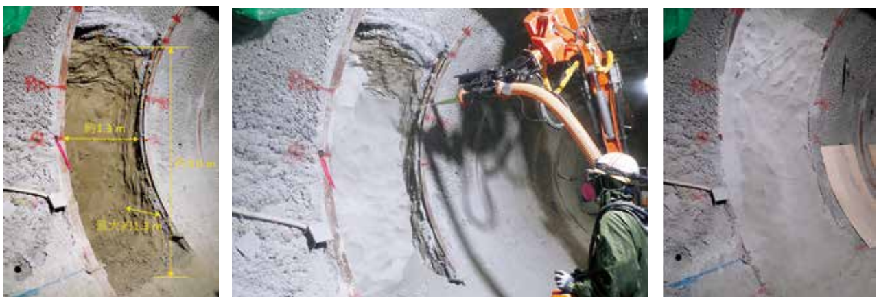
図 坑道の側壁に設けた切欠き部（左）、粘土材料の吹付けの様子（中）と吹付け完了時の様子（右）
